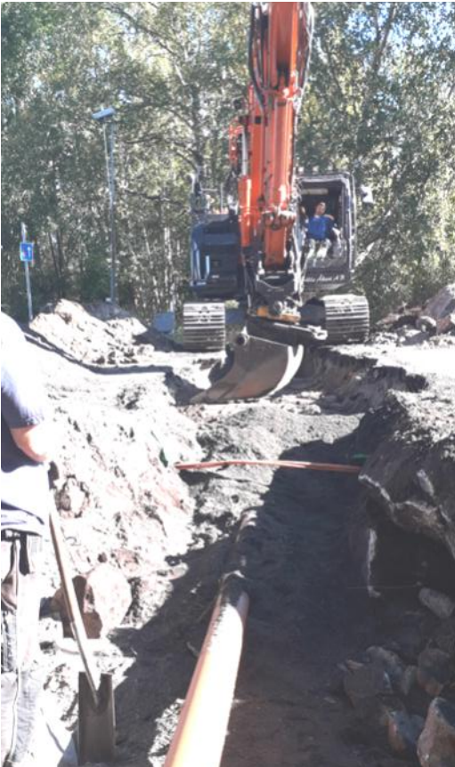
Under många år har det varit flera läckor. Vallviks intresseförening har de senaste åren lagt ner mycket pengar och ideellt arbete på att förnya sommarvattensystemet.
